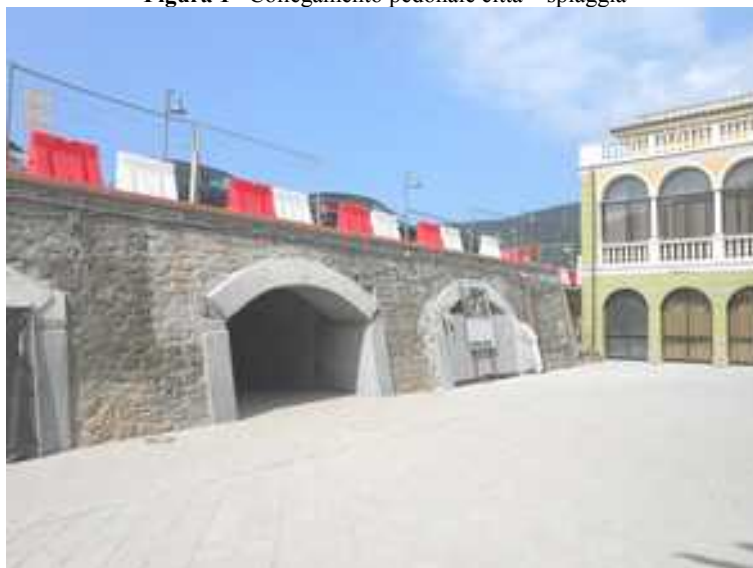
Figura 2 – Muraglione di contenimento terrapieno ex-tracciato ferroviario, con varco per passaggio pubblico in fase di realizzazione
